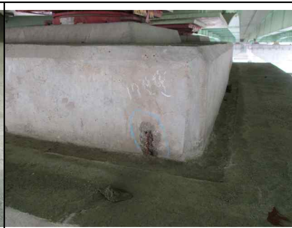
일산방향 P23-SH3 받침콘크리트 철근노출
