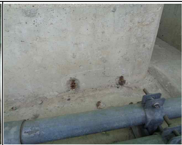
인천방향 P12-SH4 받침 콘크리트 철근노출
