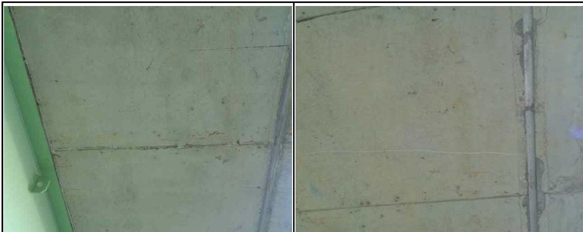
S1 켄틸레버 균열
