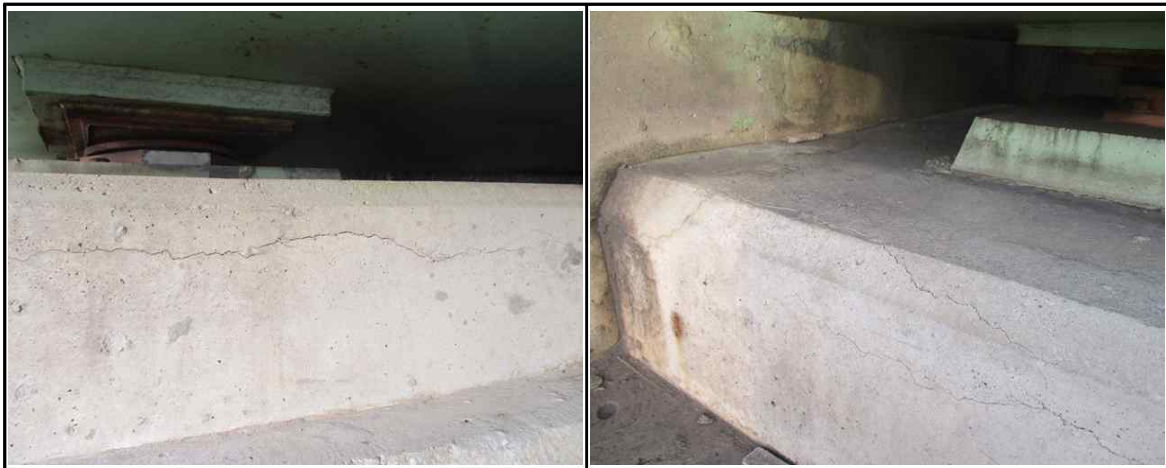
P4-SH4 받침콘크리트 들뜸
