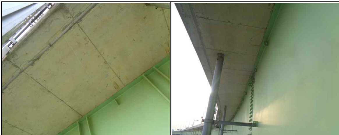
S2 켄틸레버 균열
