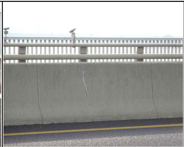
인천방향 S21 중분대 균열
