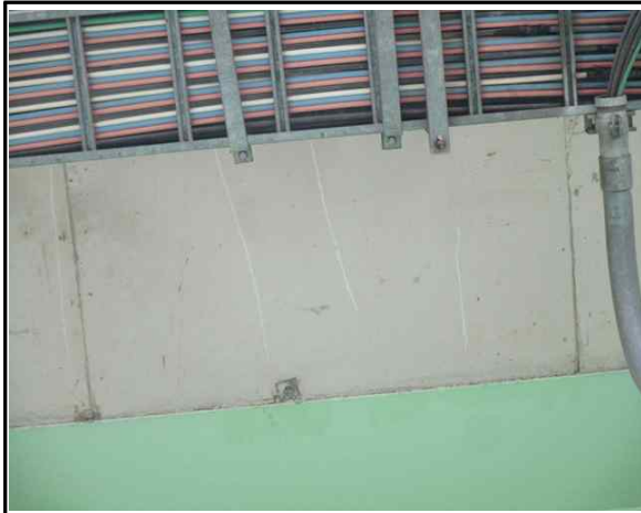
인천방향 S19 켄틸레버 폭 0.3mm미만 균열
