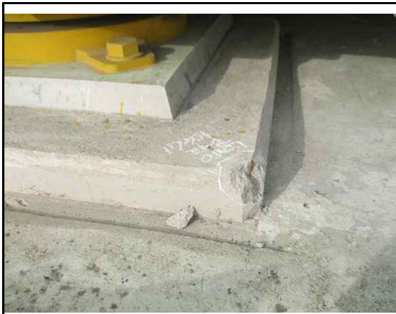
일산방향 P10-SH1 받침콘크리트 파손
