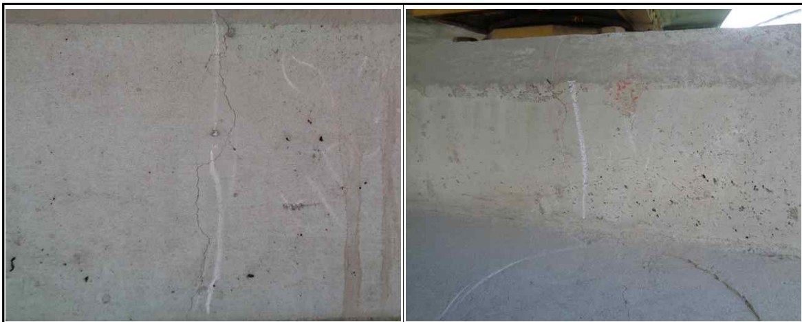
P5-SH1 받침콘크리트 균열
