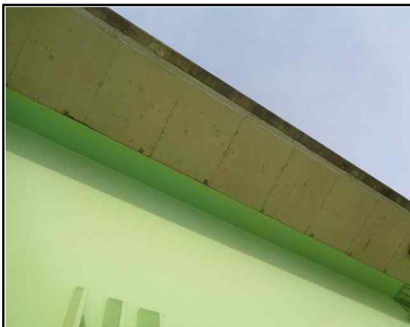
인천방향 S11 켄틸레버 폭 0.3mm미만 균열
