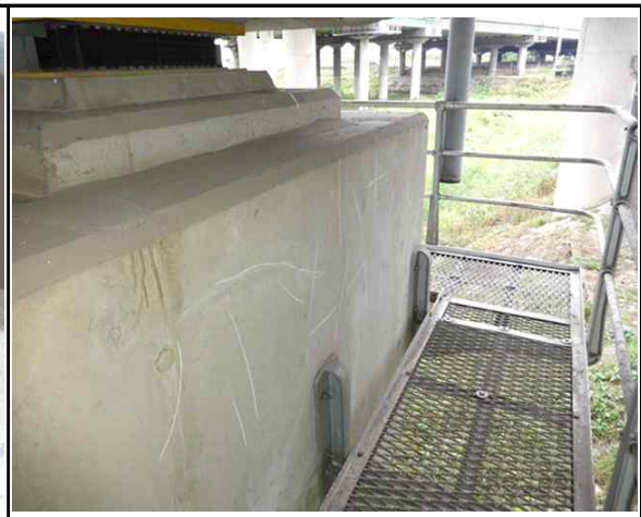
P6 코핑부 배면 망상균열
