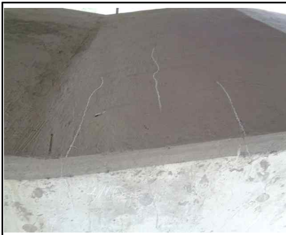
P7 코핑부 상면 균열
